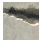
ภาพที่ 1 แสดงภาพรอยแตกร้าวโครงสร้างคอนกรีต
